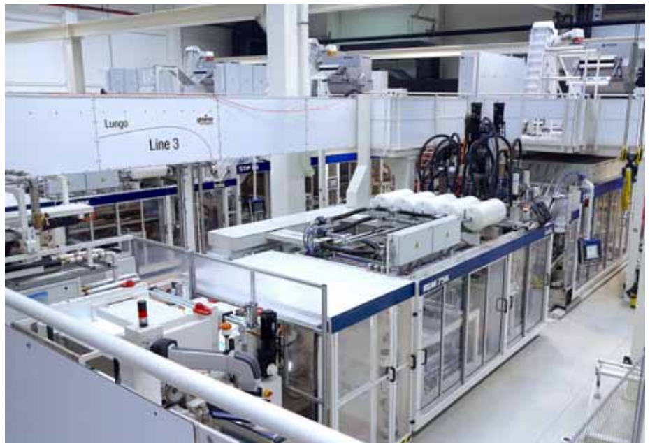
Die aus der Extrusionsanlage kommende 7-Schicht-Barrieriefolie läuft direkt in eine Multikavitäten-Tiefzieh- und Stanzanlage. Das zurückbleibende Stanzgitter und allfällig anfallende Schlechteile werden direkt anschließend einer Schneidmühle zugeleitet (im Hintergrund am Maschinenende) und von dort wieder in die Produktion zurückgeführt.
