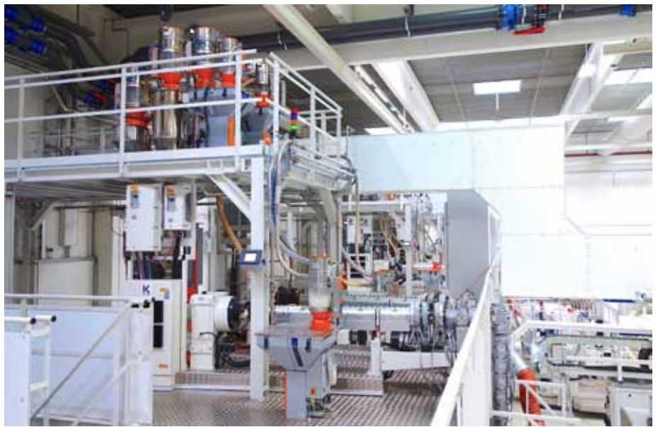
Die 7-Schicht-Folienanlage ist in drei Funktionsebenen übereinander aufgebaut. Auf der untersten Ebene (hier nicht sichtbar) befinden sich drei Extruder (siehe Abbildung 3), auf Ebene zwei befinden sich die zwei Extruder für die Deckschichten, auf der obersten Ebene die Dosiergeräte zur Versorgung der darunter befindlichen Extruder.
