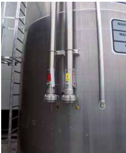
Die Füllleitungen sind durch Schlosssicherungen gegen eine Fehlfüllung gesichert.
