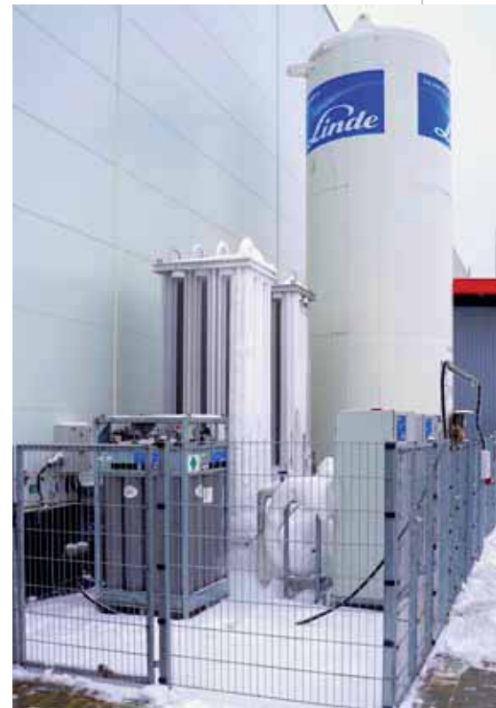
Die zentrale Gasversorgungsanlage besteht aus einem Flüssig-Stickstofftank, zwei angeschlossenen Verdampfungseinheiten in Kombination mit je einem Kompressor und einem Gasflaschenpuffer zur Stabilisierung des Systemdrucks.
